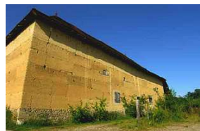
Exemple de bâtiment n'ayant pas été enduit depuis sa construction. Le pisé n'a pas subi d'altération due à l'érosion.
