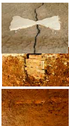
Exemple de réparation d'une fissure due à une infiltration d'eau en toiture.
